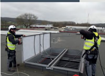
Exutoire de fumée
