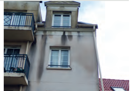
Coulures sur façade
