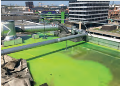
Recherche de fuite
